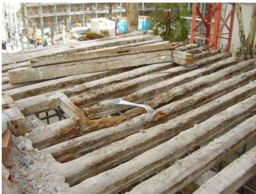
Estado de viguetas de madera en forjado de planta primera en Sala de Café
