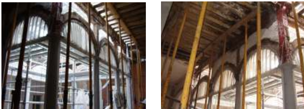
Galería Patio de Viana estructura madera atacada.
