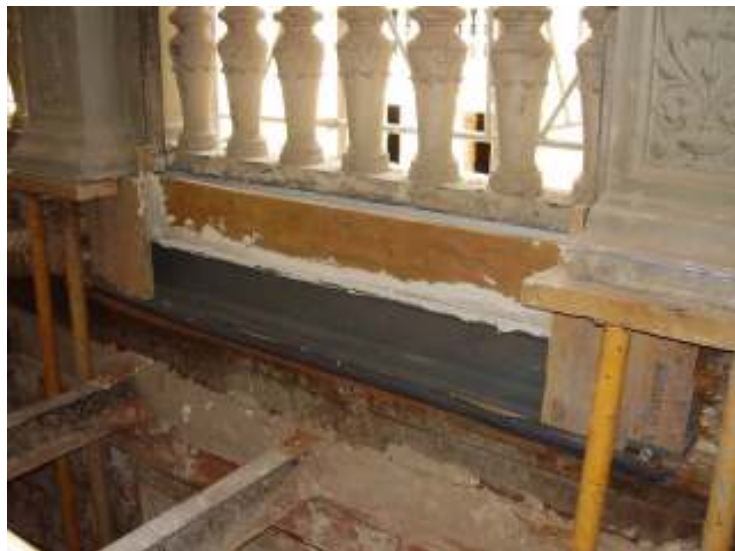
Detalle de sustitución de durmientes en Patio de Rivas por vigas metálicas previa consolidación del apoyo de las columnas de piedra mediante resinas y varillas de fibra de carbono.
