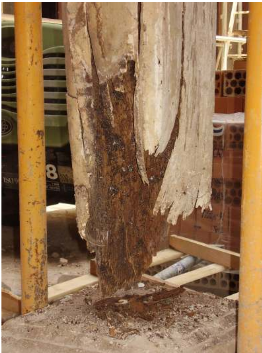
Estado de pilar de PB del Patio de Rivas
